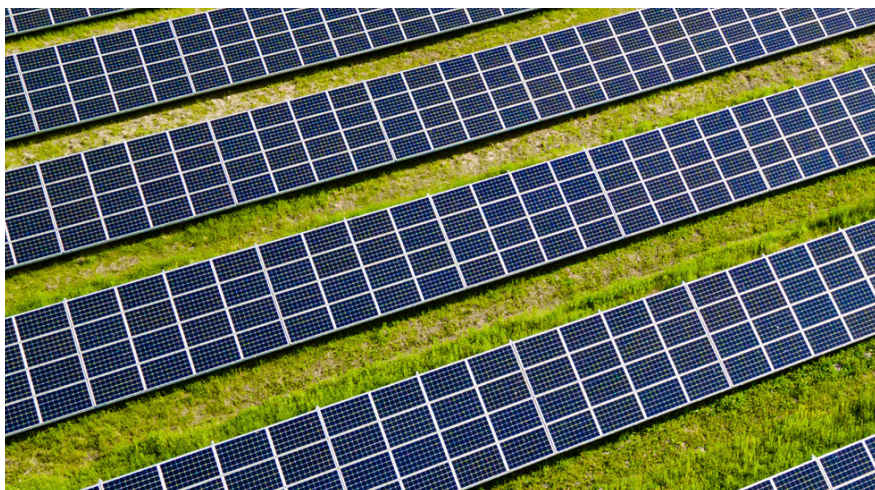
Quadro 69 - Usina fotovoltaica
