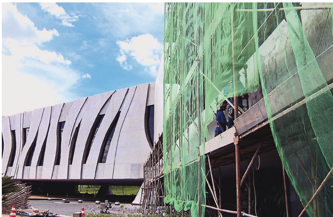
A revitalização das fachadas de concreto aparente dos prédios da sede do STJ abrangeu uma área de cerca de 17 mil m 2
